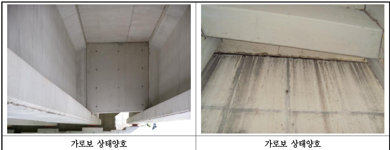
【사진 29.3.7】 가로보 손상현황
